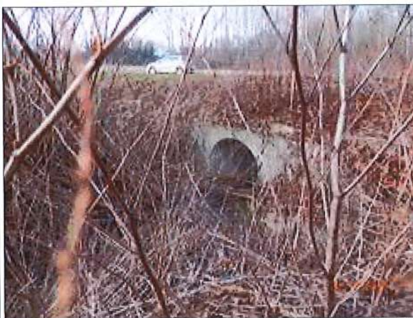
Photo 6 : La buse du canal de dérivation du ruisseau des Grottes au niveau de la RD65i.
